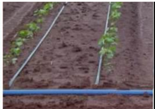
Terciarias de polietileno expuestas
