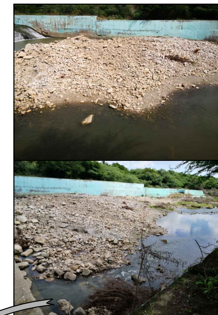
SEDIMENTOS EN LA DESCARGA DEL DIQUE
