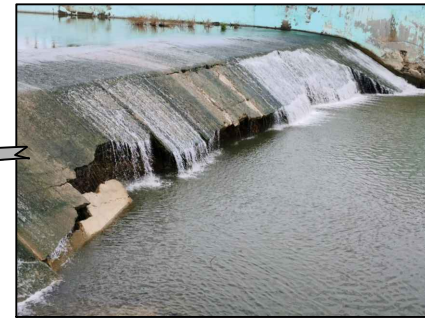
REVESTIMIENTO DE H.A. A RECONSTRUIR EN CIMACIO Y CUENCO AMORTIGUADOR
