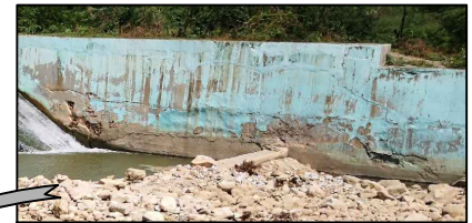
GRIETAS A RESANAR EN AMBAS MARGENES EN MUROS OREJAL
