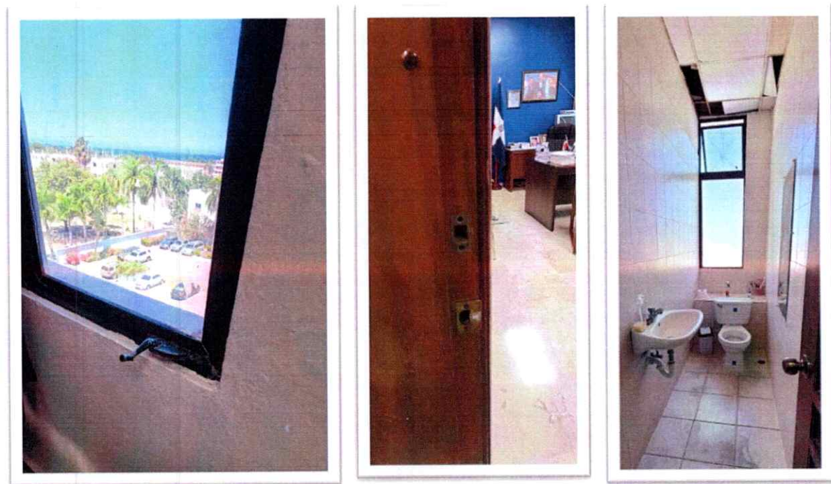
Ilustración 6. La imagen de la derecha muestra una ventana con un operador defectuoso, mientras que la imagen de la derecha muestra 2 frontales de cerradura para puertas defectuosos y el baño.
