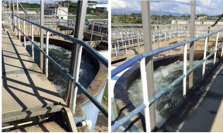
Fotos de la llegada de agua cruda en los módulos de tratamiento. Observar la gran turbulencia en el pasaje en lo vertedor
