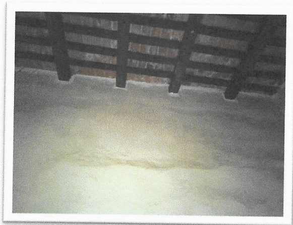
Pared norte del salón principal, ver filtraciones
