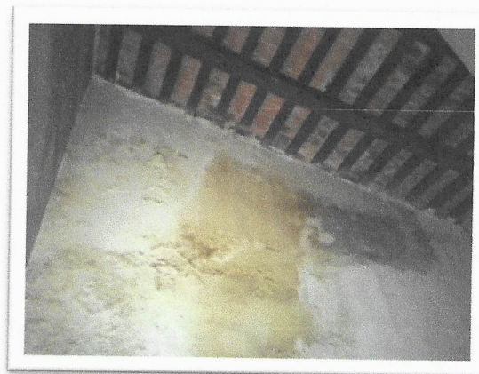
Pared sur-oeste, ver filtracion
