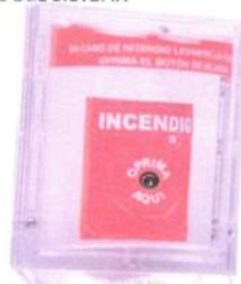
BOTÓN PULSOR DE INCENDIO
